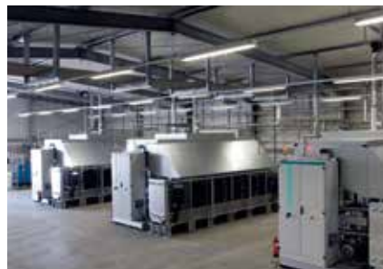
PEM-Elektrolyseure (Proton Exchange Membrane)
